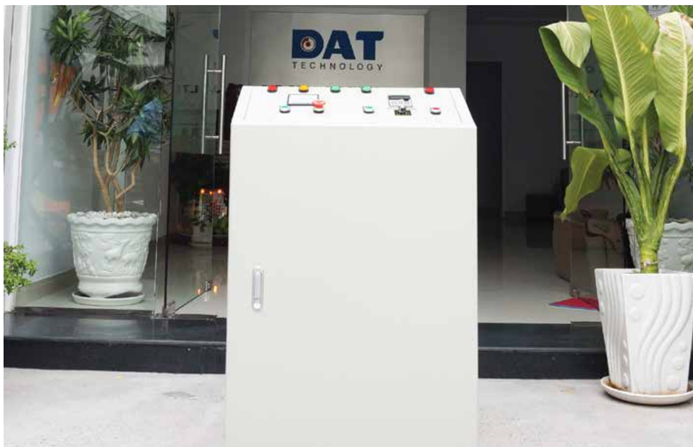
Biến tần GD200A: Tủ điện GD200A cho ly tâm cống cột điện tại nhà máy Z751
