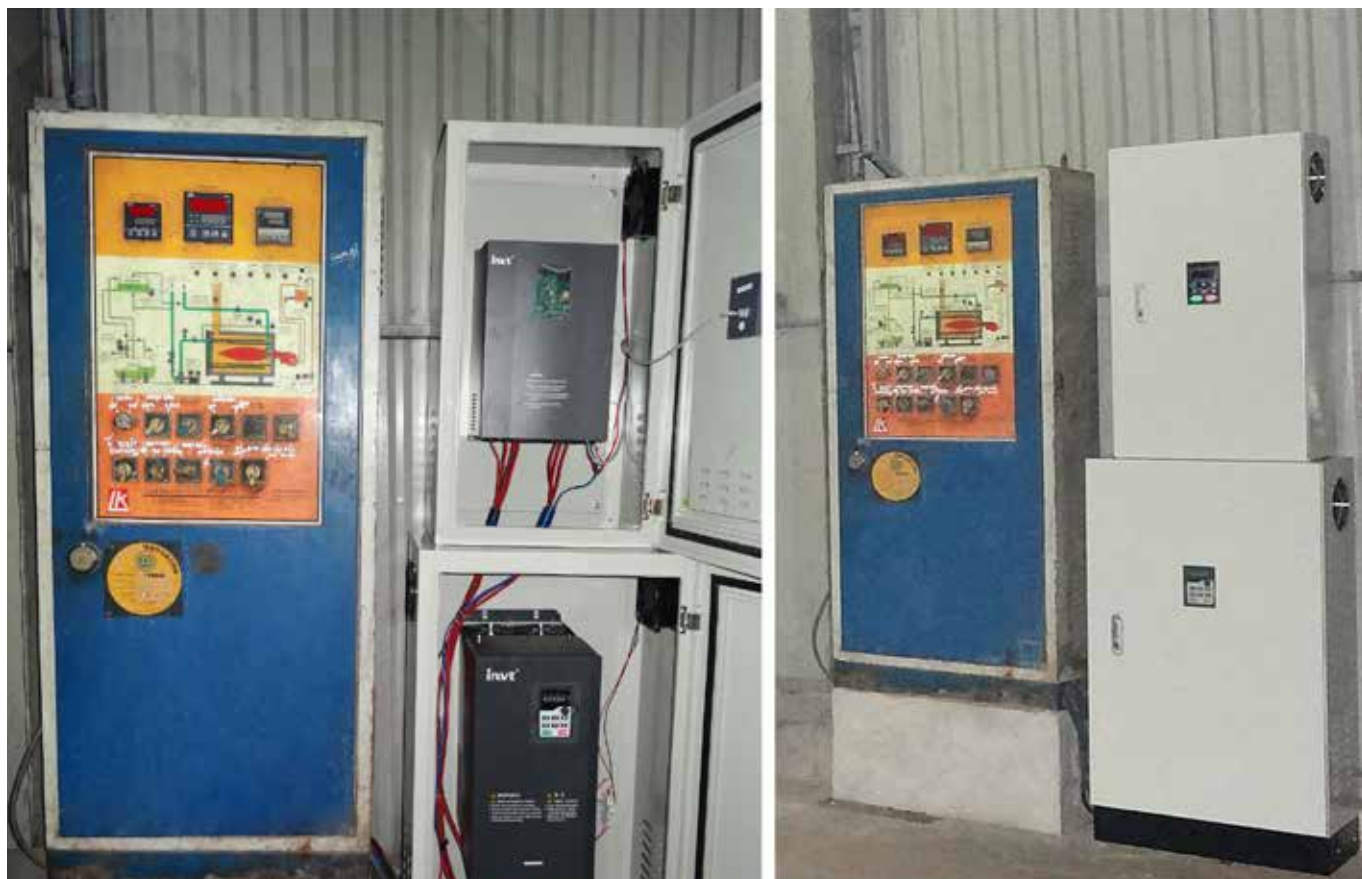
Biến tần GD200A: Tủ điện cho lò hơi ngành nhuộm / Công ty Thuận Phát - KCN Lê Minh Xuân, TP.HCM
