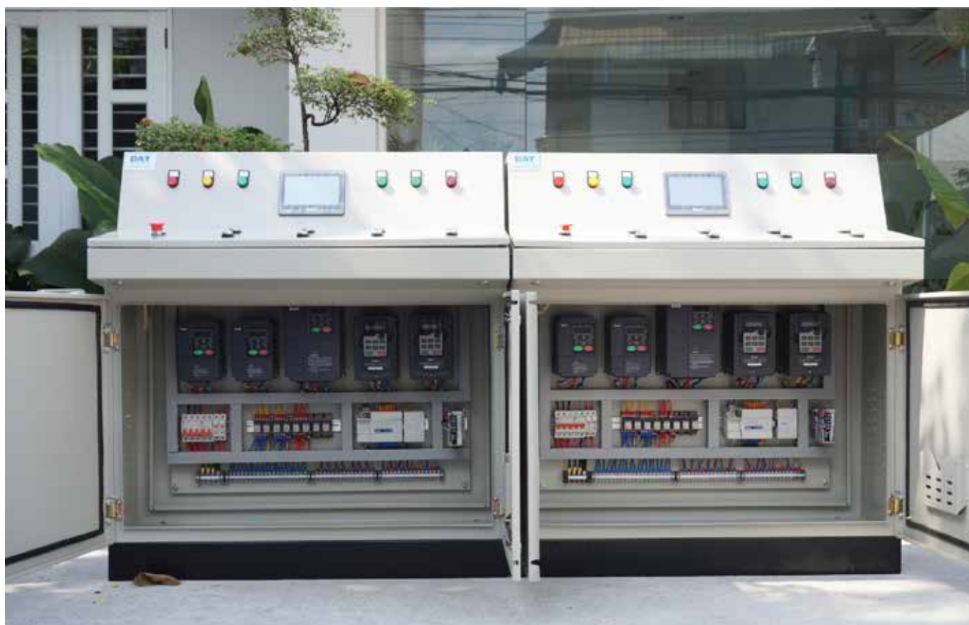
Biến tần GD35, HMI, PLC: Tủ điều khiển máy xoắn dây - Ngành sản xuất dây
