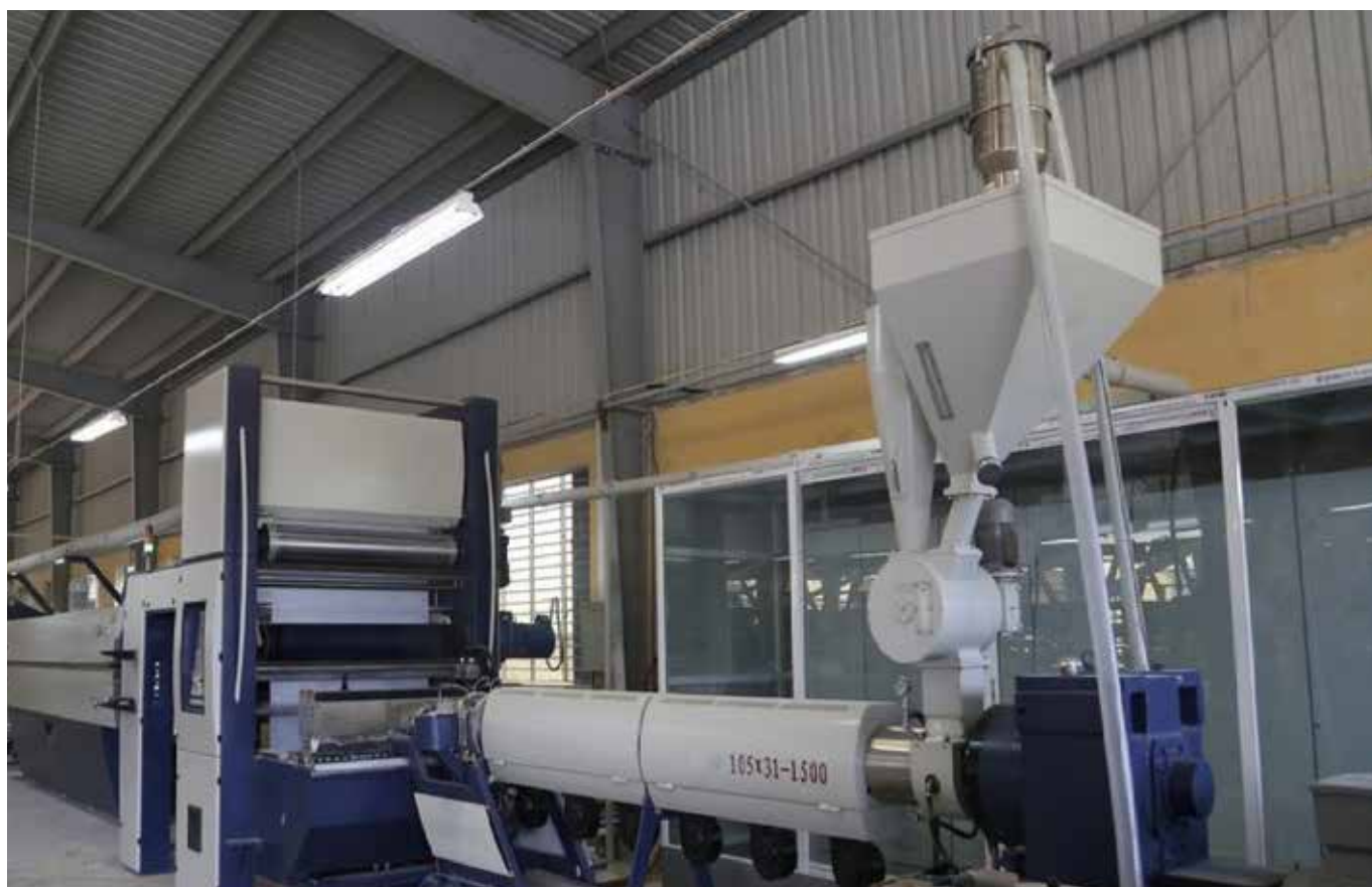
Biến tần CHF100A, Servo, PLC, HMI: Biến tần INVT cho máy tạo chỉ PP ở Công ty Đông Tiến Quân
