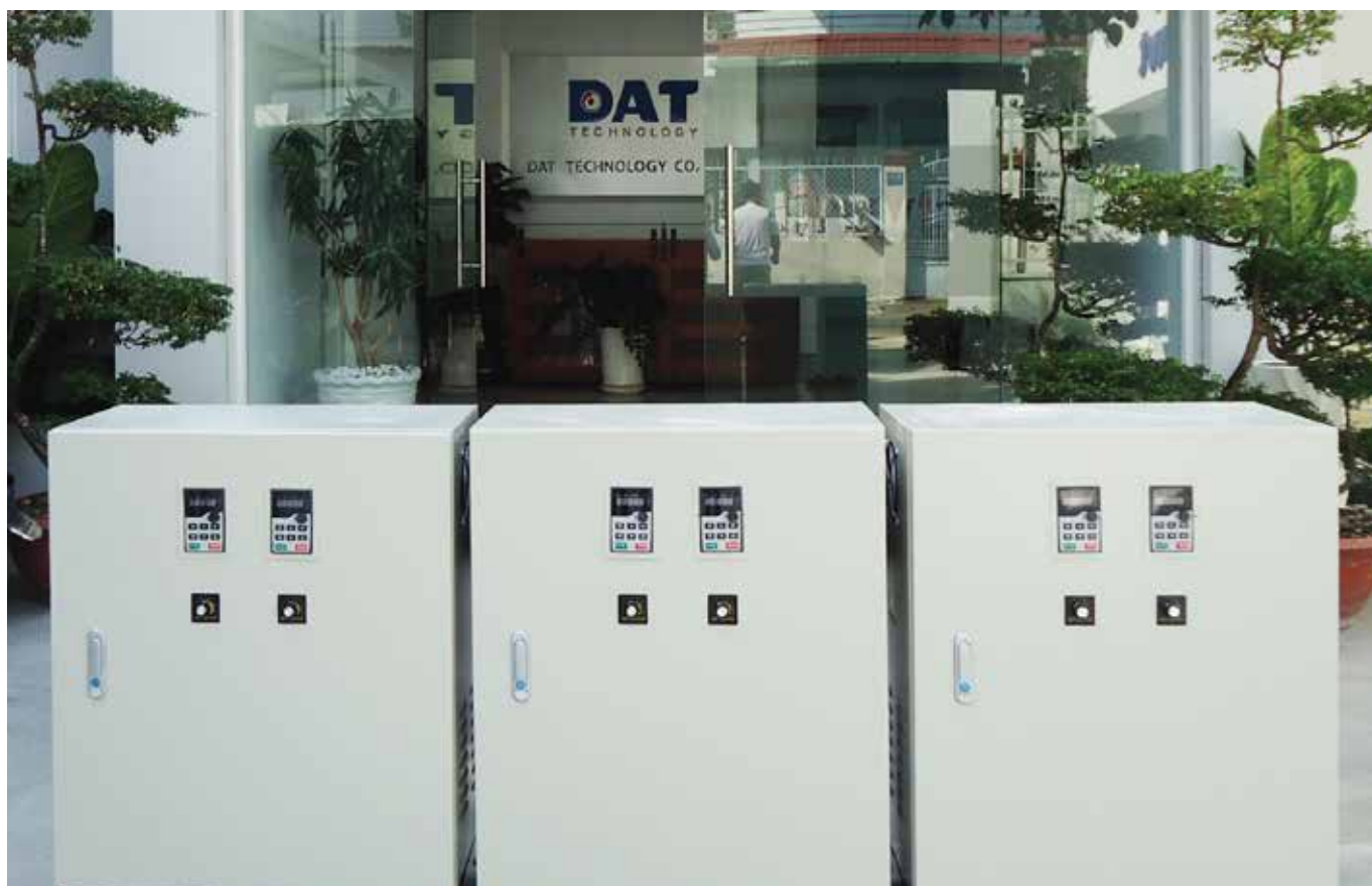
Biến tần GD200A: Biến tần INVT cho hệ thống quạt lò gạch tuynel - Công ty Phước Lập, Tây Ninh
