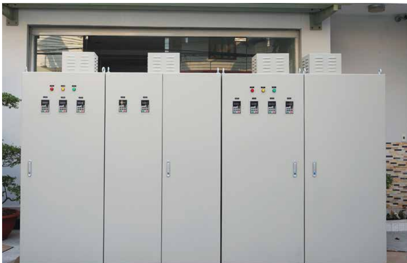
Biến tần GD200A: Tủ điện 75 kW cho máy hút bụi tại nhà máy gỗ - Bình Định
