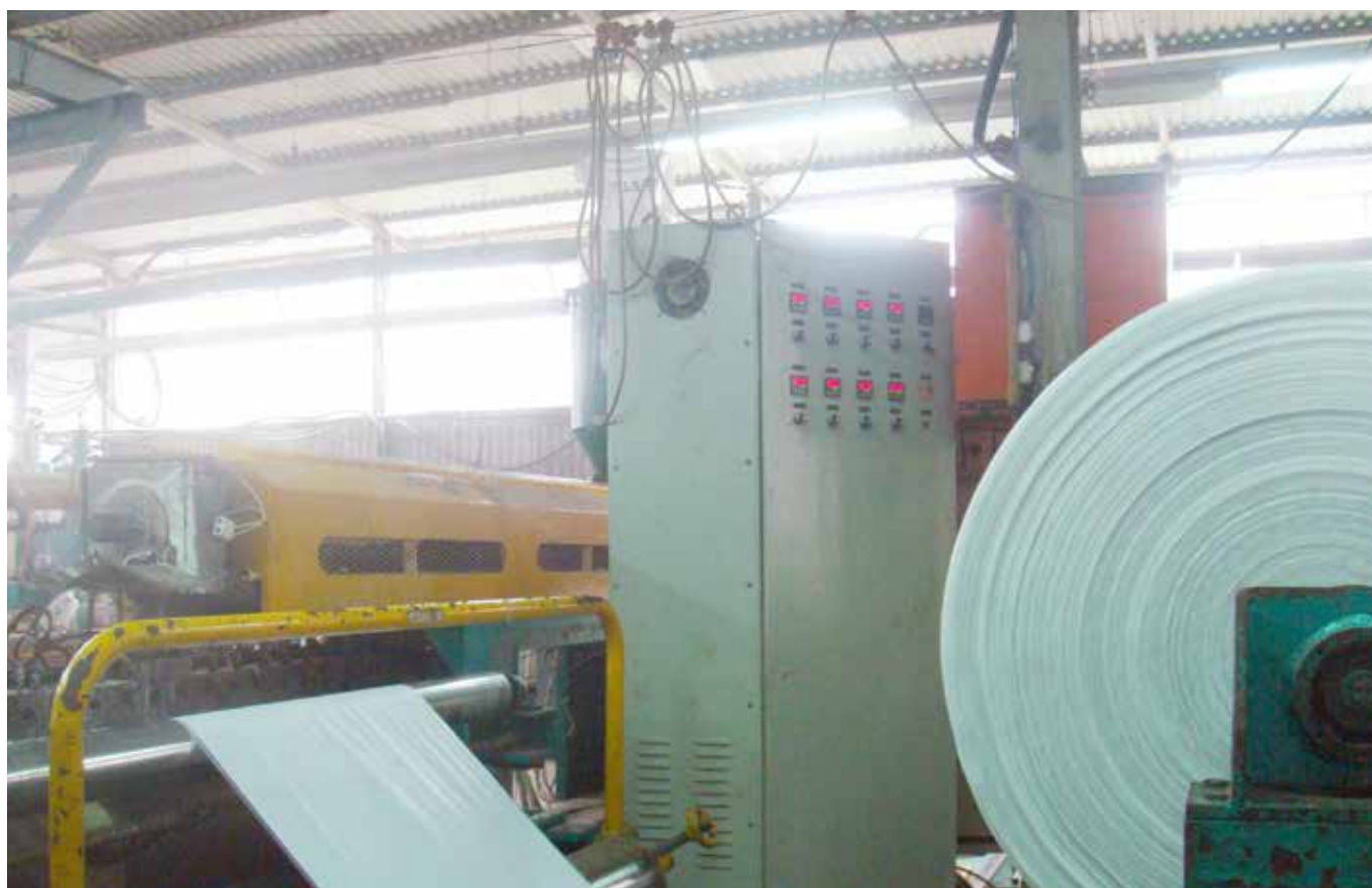
Biến tần CHF100A: Biến tần INVT cho máy tráng màng tại nhà máy Vinh Hoa
