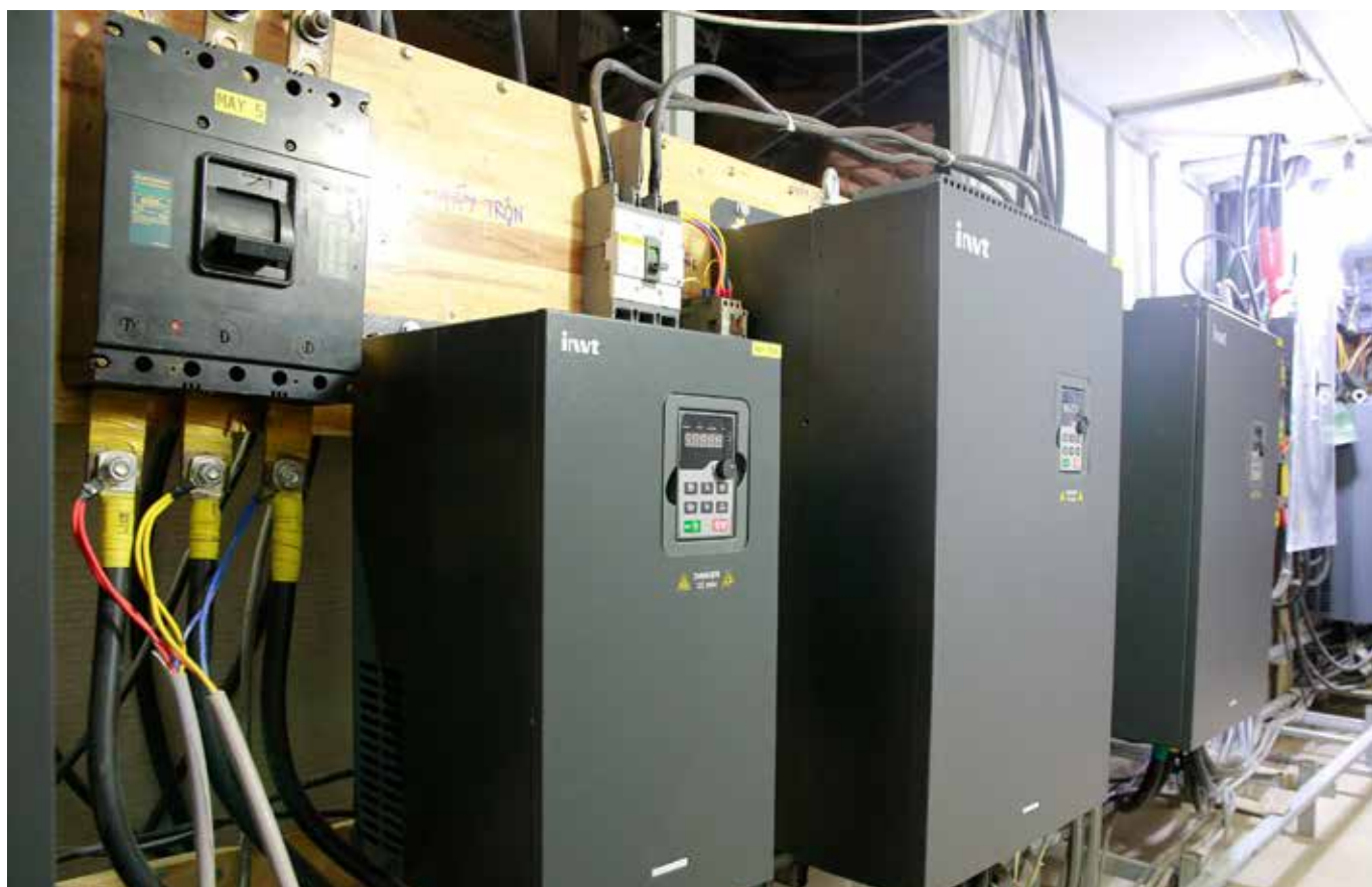
Biến tần CHF100A: Biến tần cho máy viên nén mùn cưa dạng đứng tại nhà máy gỗ - Tuyên Quang
