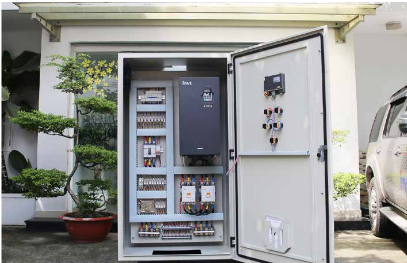
Biến tần GD200A: Tủ điều khiển hệ thống máy nén khí
