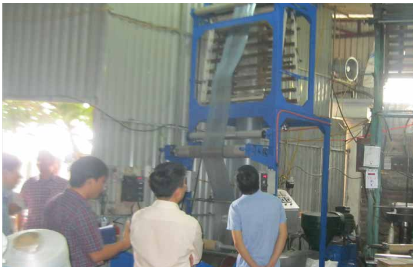
Biến tần GD200A & GD20: Điều khiển máy thổi túi nylon
