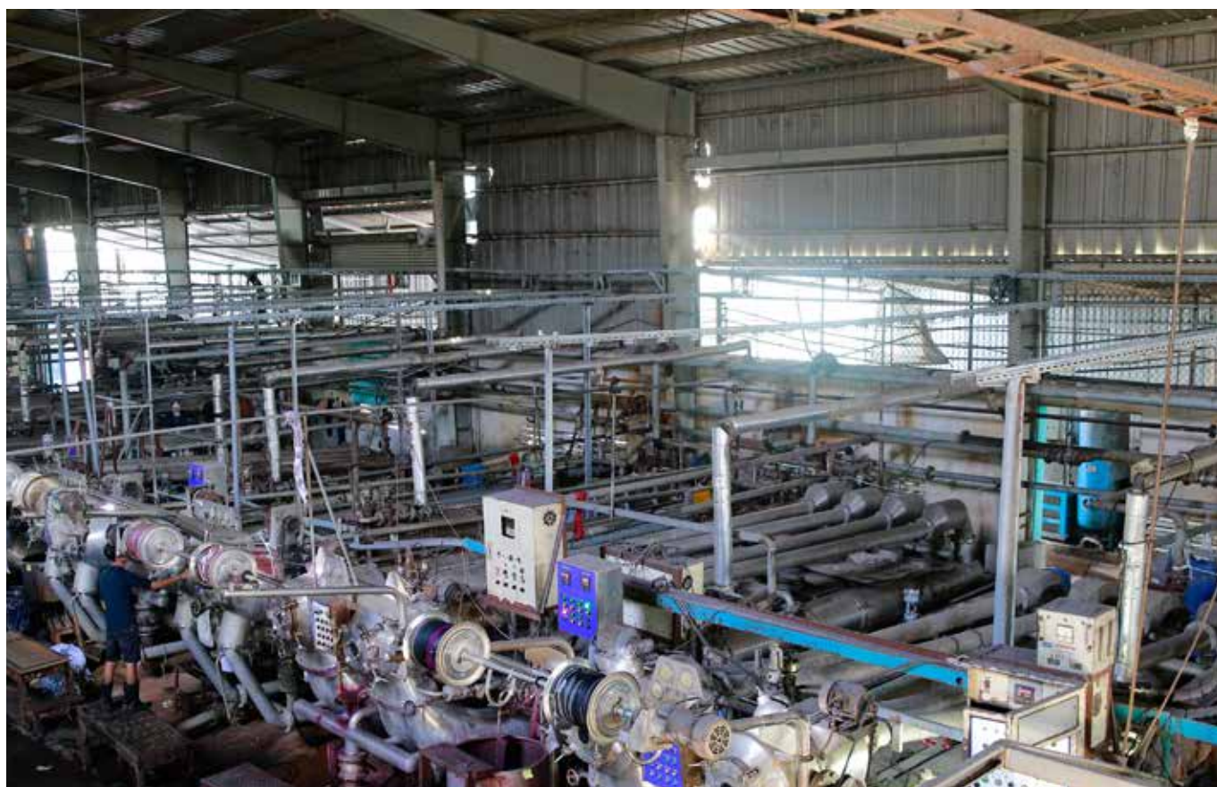
Biến tần CHF100A, GD200: Cho bơm tuần hoàn của máy nhuộm JET - Tại Công ty Dệt Nhuộm Thiên Hưng
