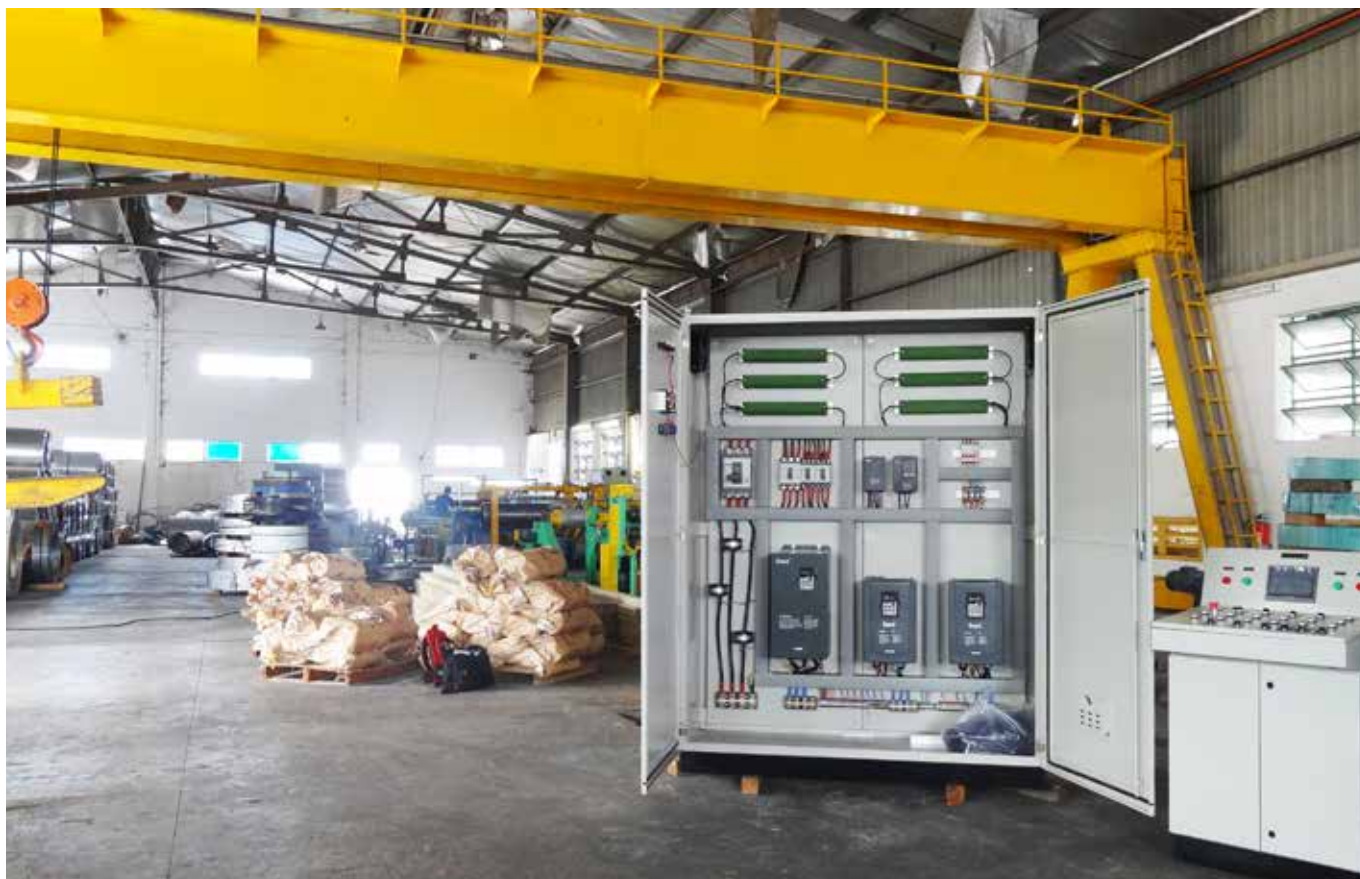
Biến tần CHF100A: Tủ điện máy cán thép 280kw cho Công ty Thép Tuấn Võ
