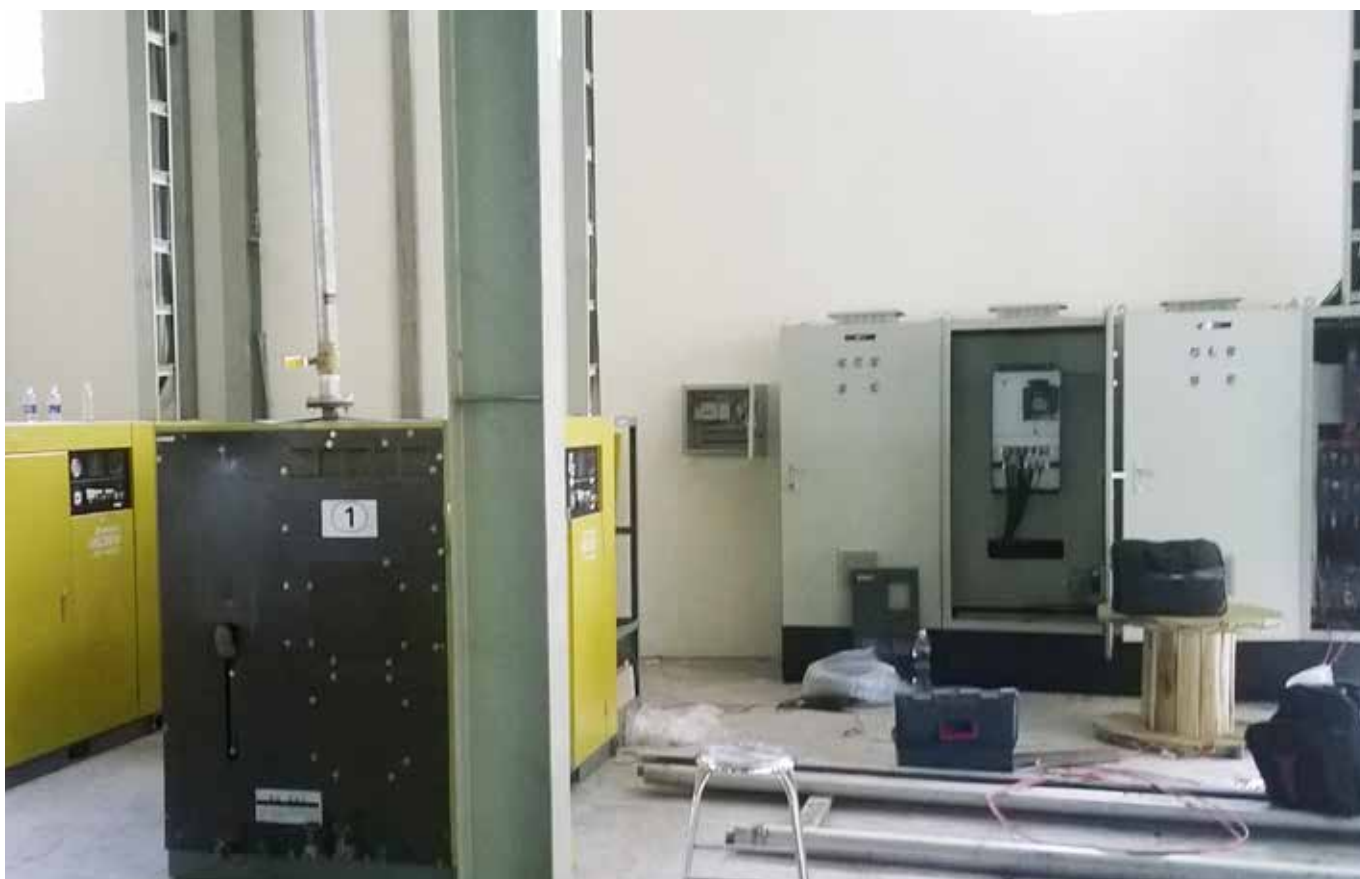
Biến tần GD200, PLC, HMI: Điều khiển hệ thống máy nén khí
