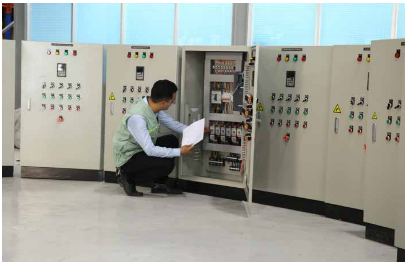
Biến tần GD300-16: Tủ điều khiển hệ thống đa bơm sục khí nuôi tôm - Tập đoàn Việt Úc
